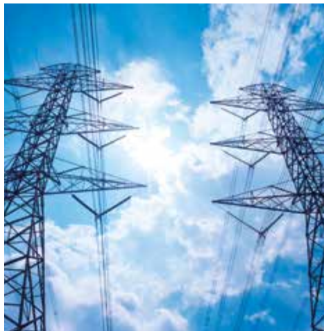
Mast mit Hochspannungsfreileitung
