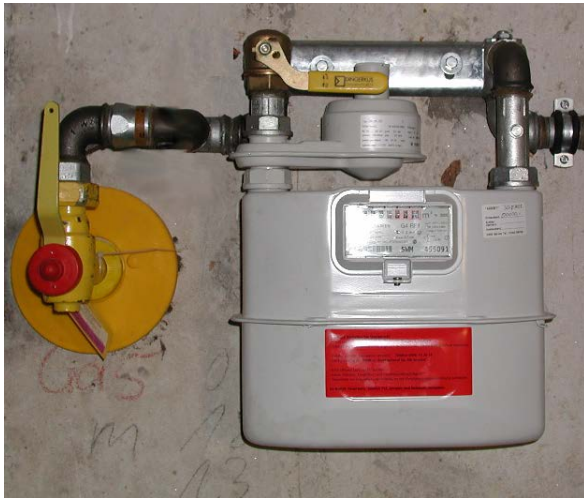
Abbildung 5.5: Einzelspartenanschluss mit Gaszähler und Zählerregler
