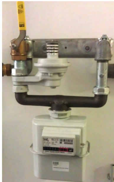
Abb. 10: Einrohr-Gas-Messeinrichtung mit Passstück an einer Zweirohr-Gas-Messeinrichtungsplatte mit Gasdruckregler
