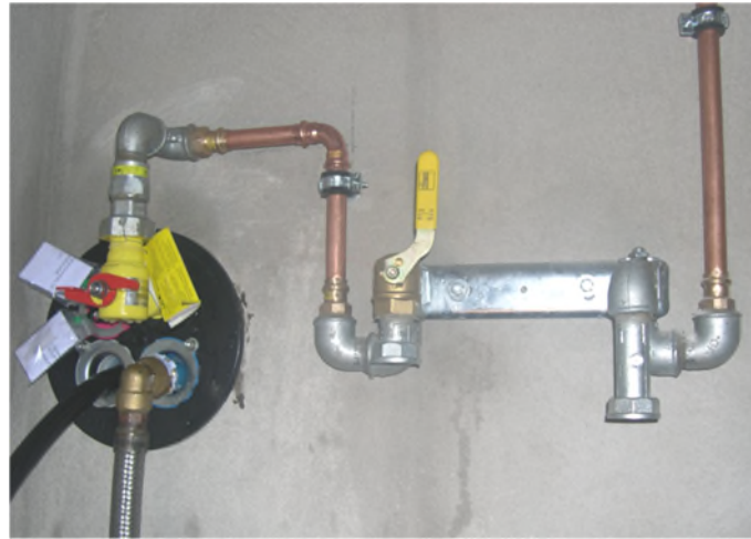
Abb. 11: Messeinrichtungsanschlussplatte in der Gas-Hausinstallation
