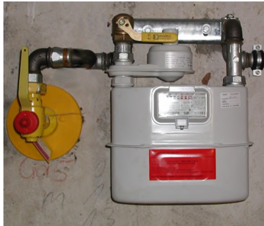
Abb. 5: Beispiel eines Einzelanschlusses mit Gasdruckregler und Gas-Messeinrichtung
