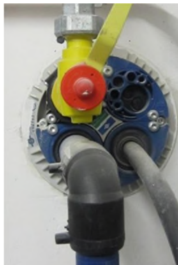
Abb. 6: Beispiel einer Mehrsparteneinführung
