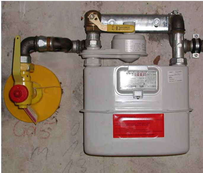
Einzelspartenanschluss mit Gaszähler und Zählerregler
