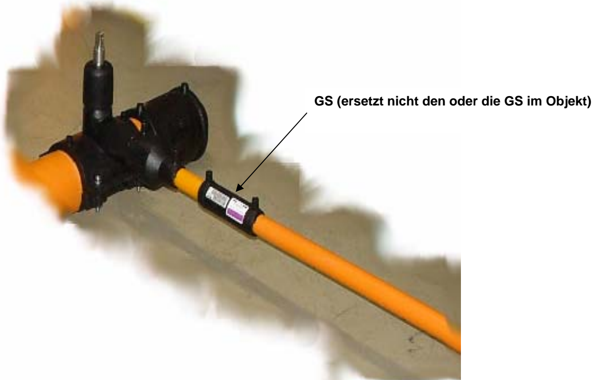
Verteilleitung mit Netzanschlussleitung und Gasströmungswächter (GS).
